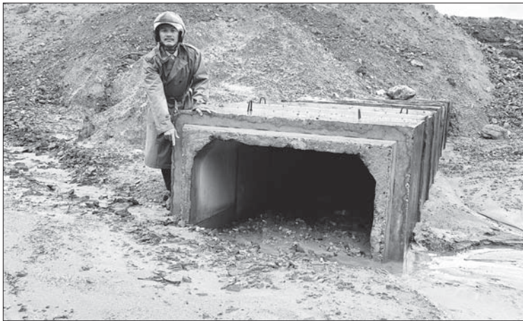
Tuyến kênh N-VC16-2, đoạn qua thôn An Hội Nam 1, xã Nghĩa Kỳ (Tư Nghĩa), bị sa bồi nặng, ảnh hưởng đến năng lực dẫn nước tưới phục vụ sản xuất cho hơn 45ha đất lúa.
