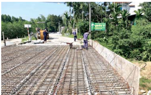
Cầu Miếu Ngói, thuộc địa phận xã Tịnh Sơn (Sơn Tịnh), trên Quốc lộ 24B đang được thi công phần bản mặt cầu.
