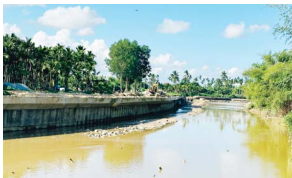
Kè chống sạt lở sông Phước Giang, đoạn qua thị trấn Chợ Chùa (Nghĩa Hành), đã đạt điểm dừng kỹ thuật, đảm bảo an toàn trong mùa mưa lũ 2024.
