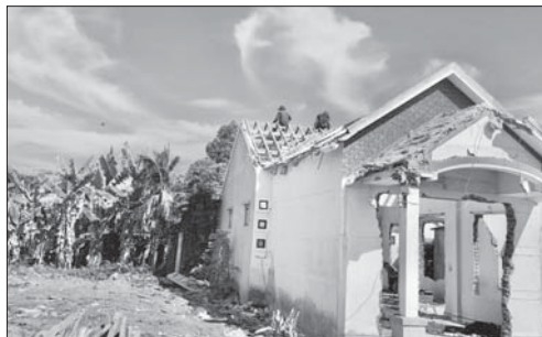
Người dân ở xã Nghĩa Kỳ (Tư Nghĩa) dỡ dọn nhà cửa, bàn giao mặt bằng xây dựng cao tốc.
